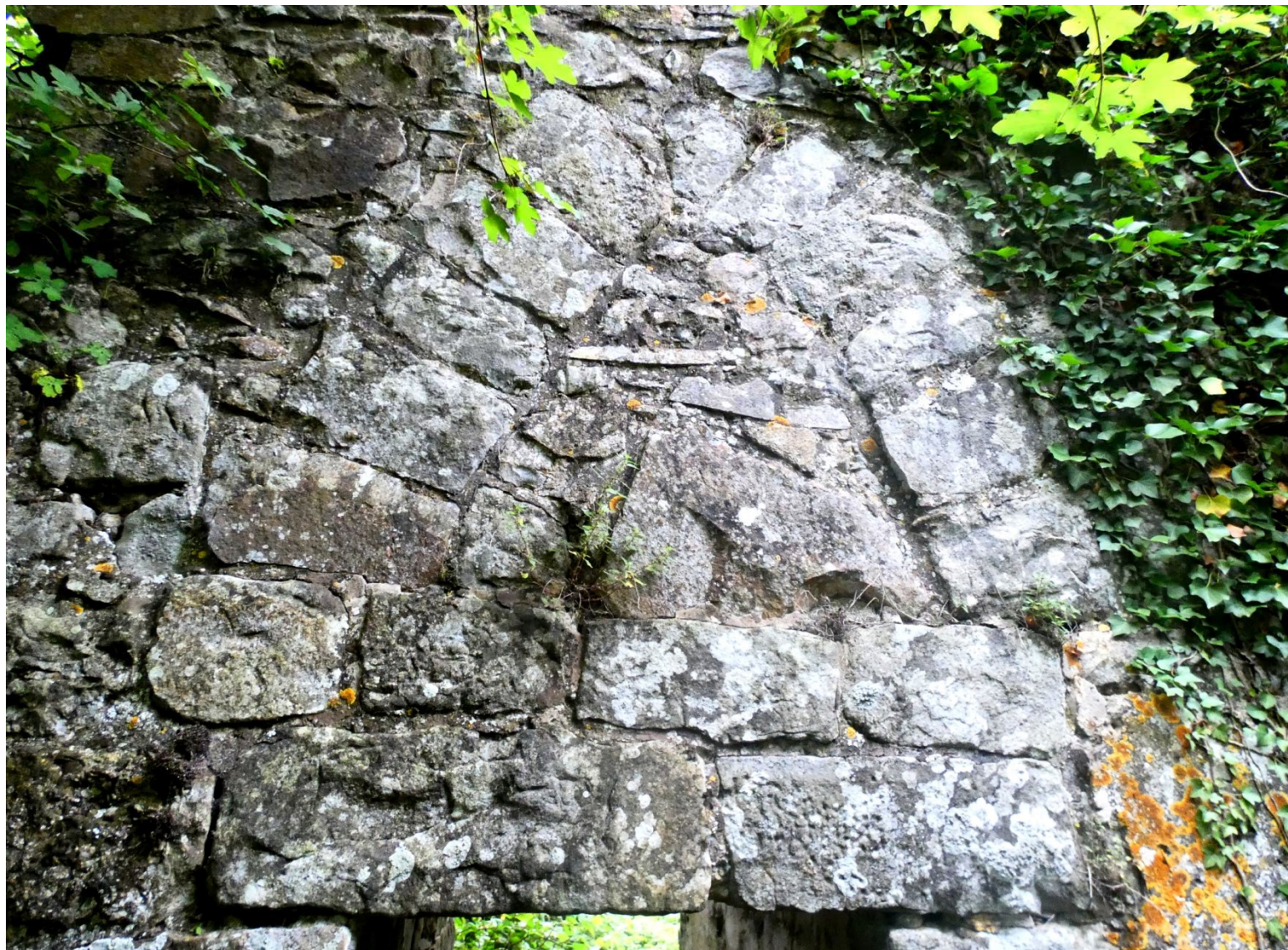
Ci-dessus : Arc de décharge
