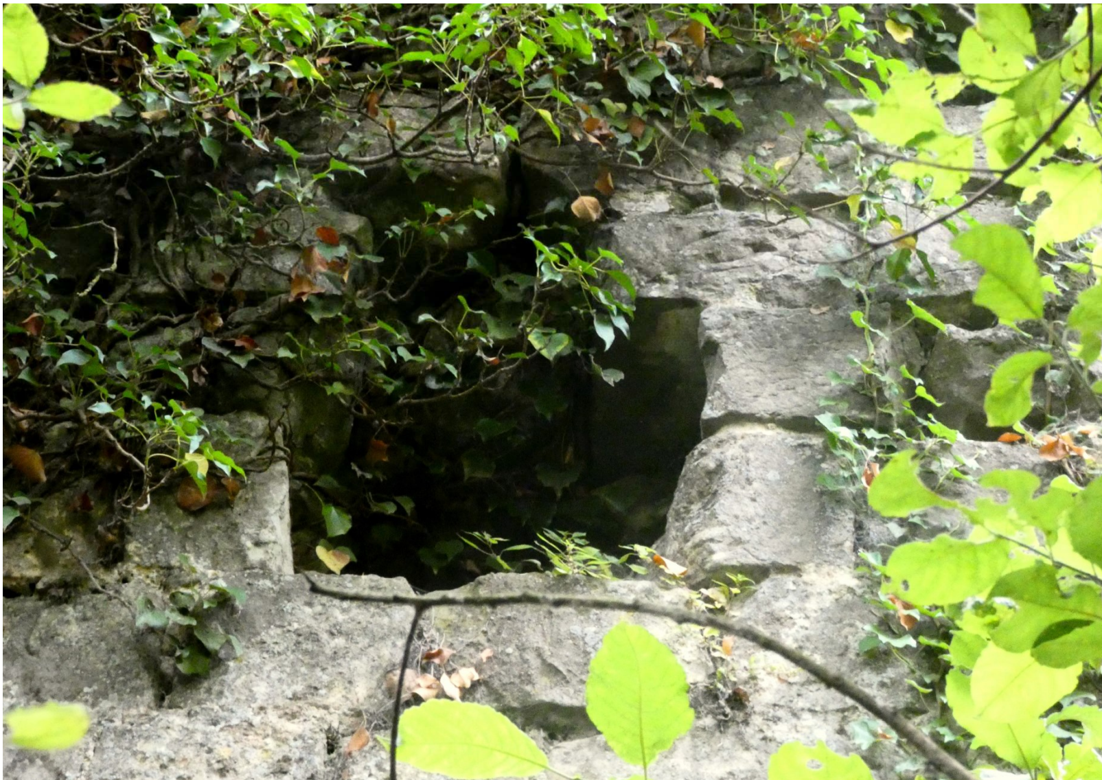
Ci-dessus : dans la partie supérieure du mur sud, l'on distingue encore une ouverture rectangulaire étirée en longueur
