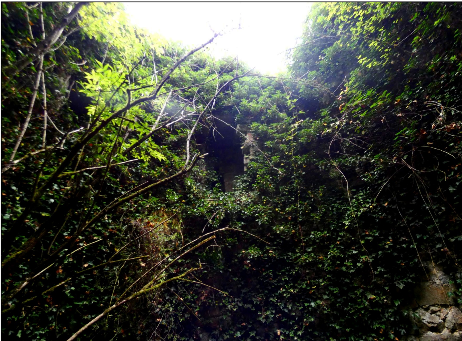
Ci-dessus : vue de la partie supérieure de la tour d'angle nord-ouest. L'on devine sous la végétation la baie donnant accès sur l'ancien étage inférieure
