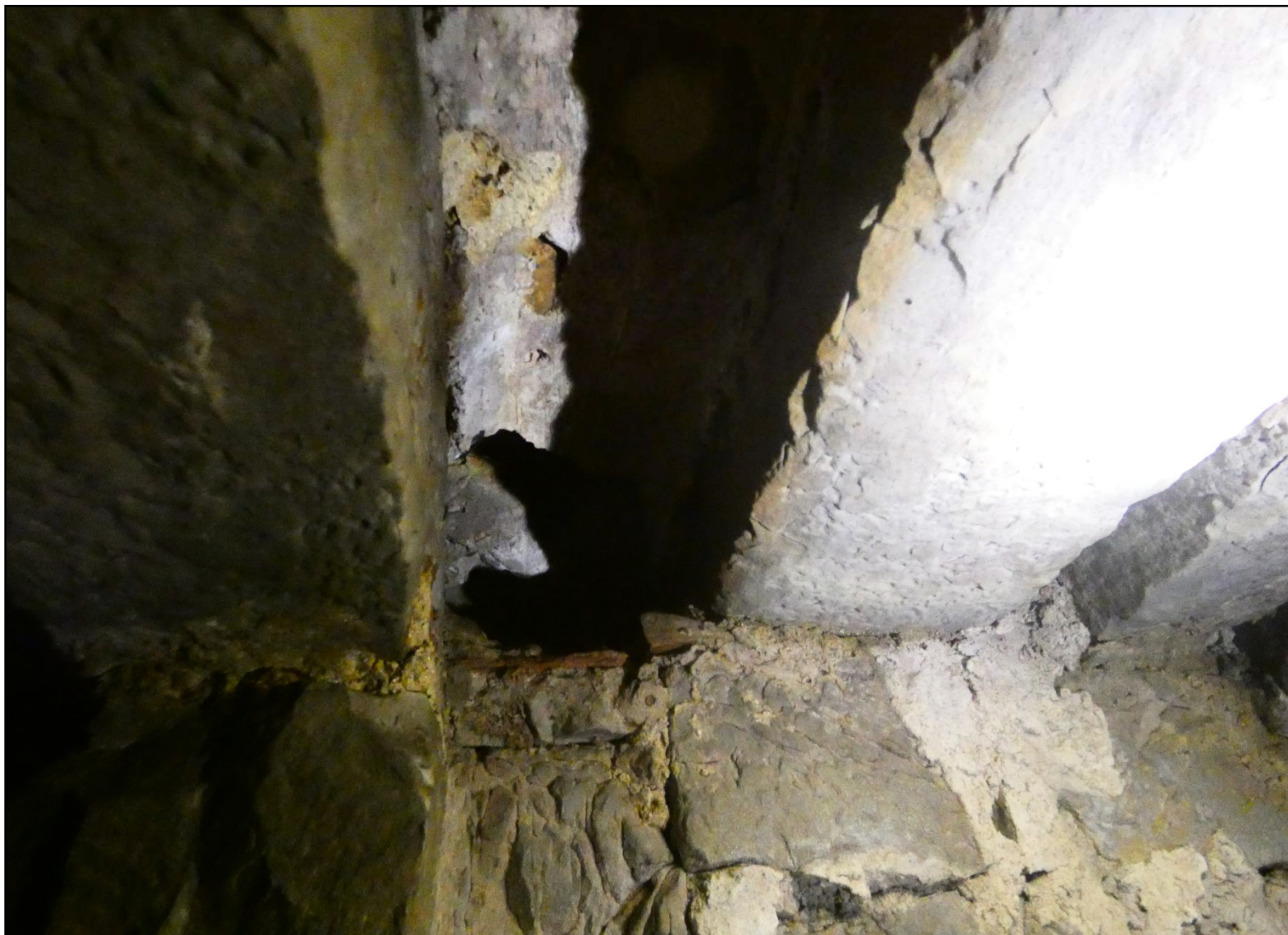
Ci-dessus : détail du mode de couverture au dessus de l'accès donnant à la seconde salle souterraine
