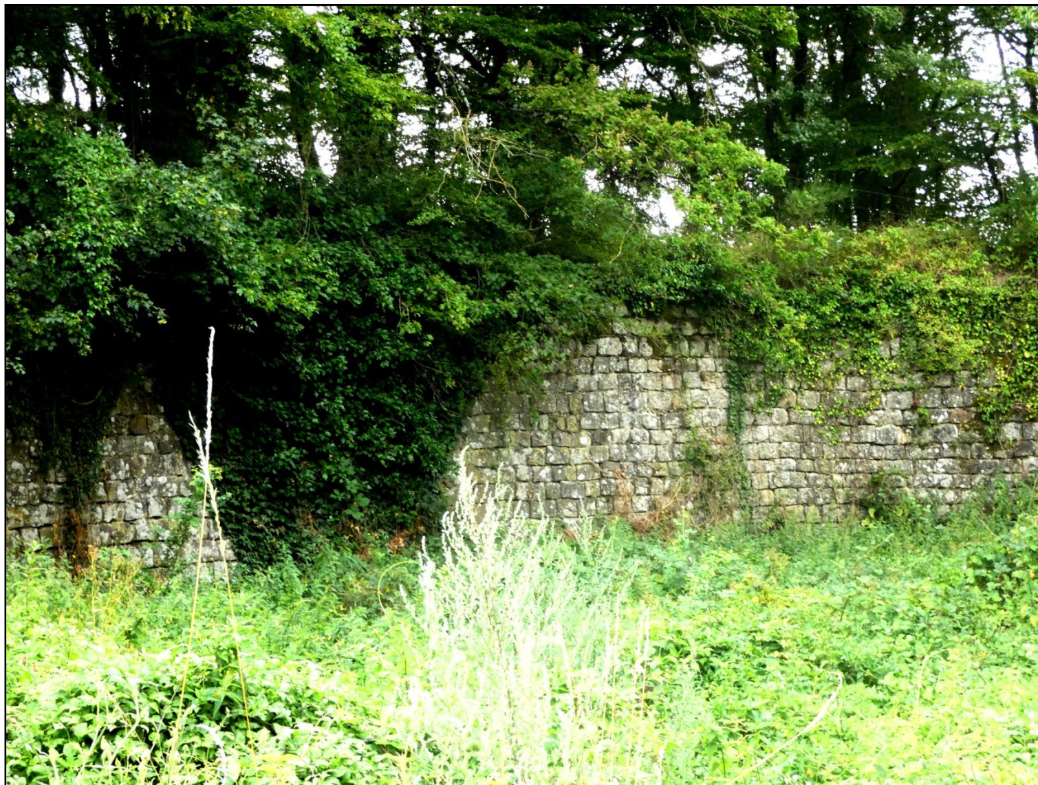
Ci-dessus : autre vue du mur maçonné délimitant les fossés secs du château de Montaiguillon
