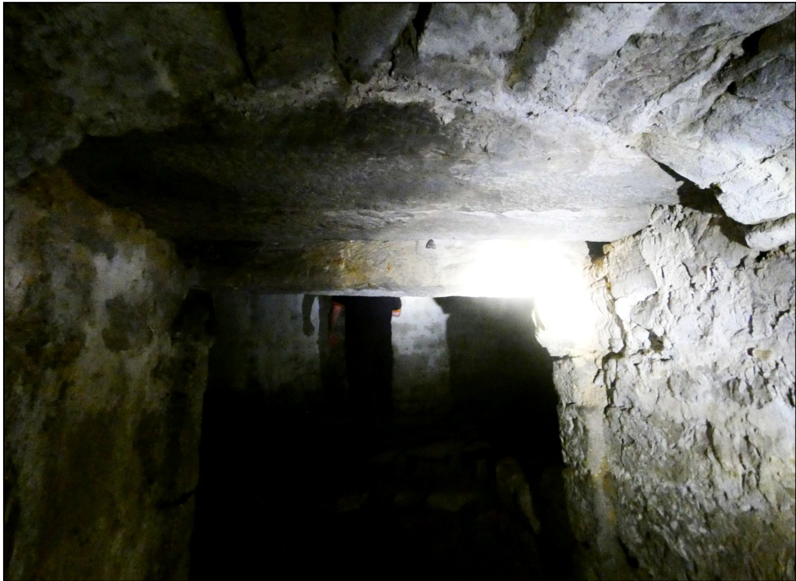
Ci-dessus : de grandes dalles de grès dominant l'accès à la seconde salle souterraine
